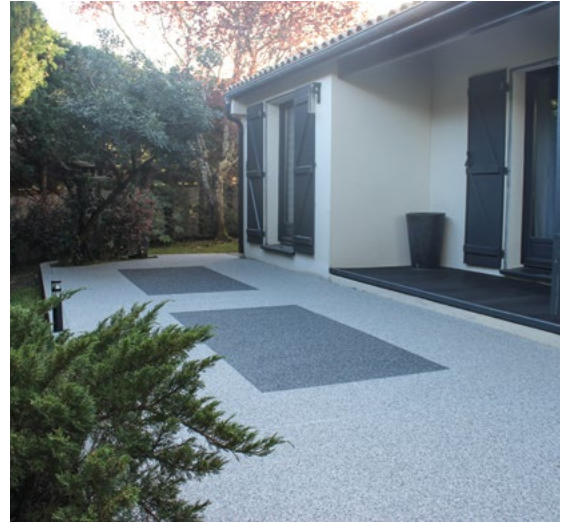
L'avantage de la moquette de pierre tient également dans la possibilité de créer des motifs. Ici, deux rectangles gris anthracite animent la terrasse côté entrée.
